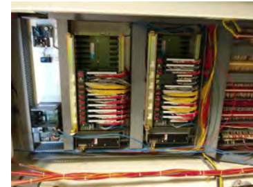
Lieb CSO, PLC Panel
