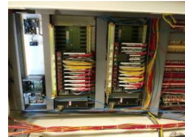
Lieb CSO, PLC Panel
